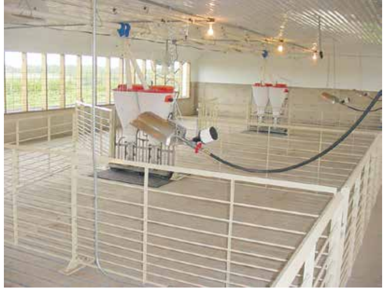
Instalación típica de Gasolec M5 en un establo porcino
